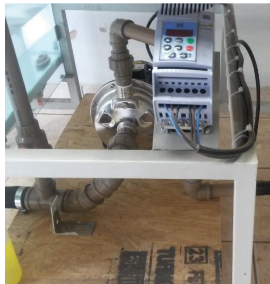
Sistema Elétrico de controle.
