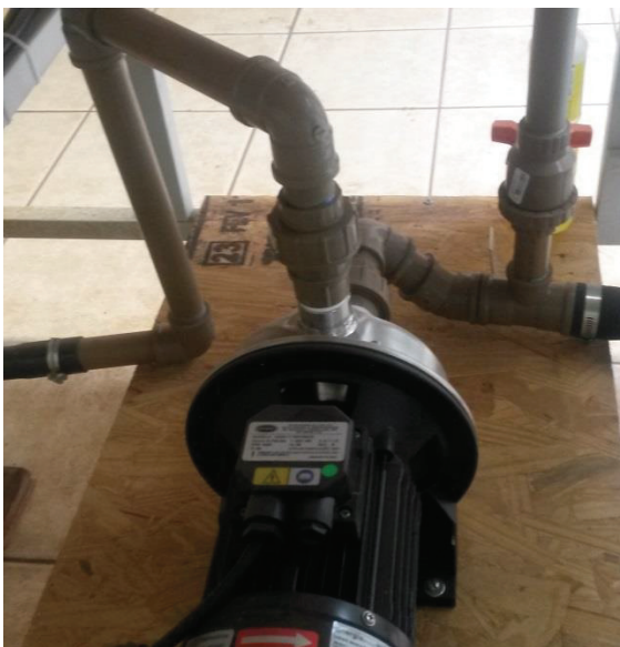
Sistema Hidráulico com encanamentos.
