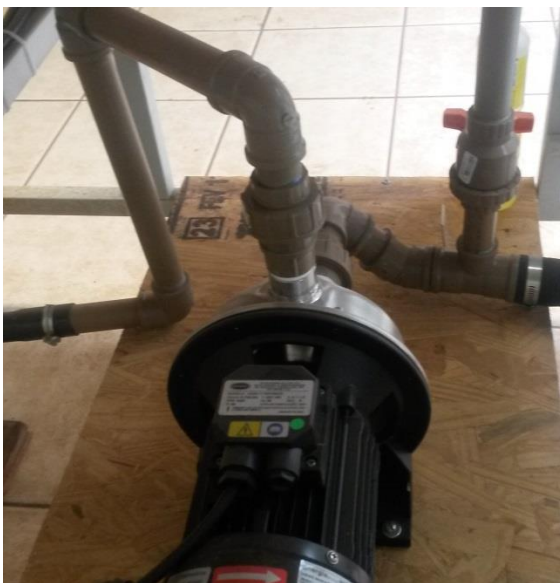
Sistema Hidráulico com encanamentos.
