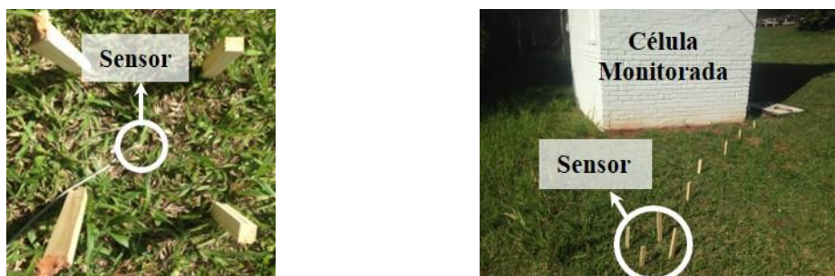
Figura 3.18 - Instalação da sonda externa do HOBO
