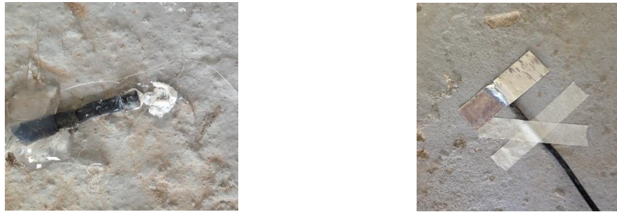
Figura 3.13 - Instalação do sensor DS18B20
