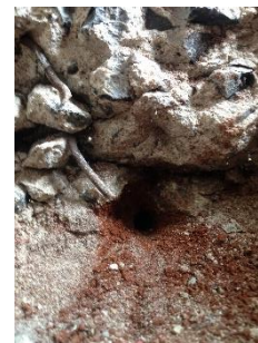
(b) Furo na interface solo/piso
