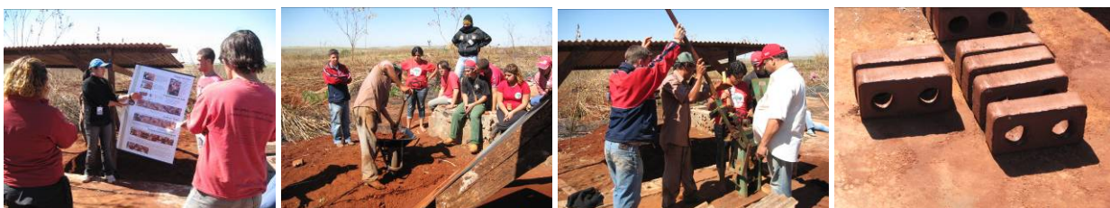
Figura 5: fotos da oficina de produção de bloco de terra comprimida, casa do Sirlei. Fonte: imagens do Grupo Habis, 2010.
