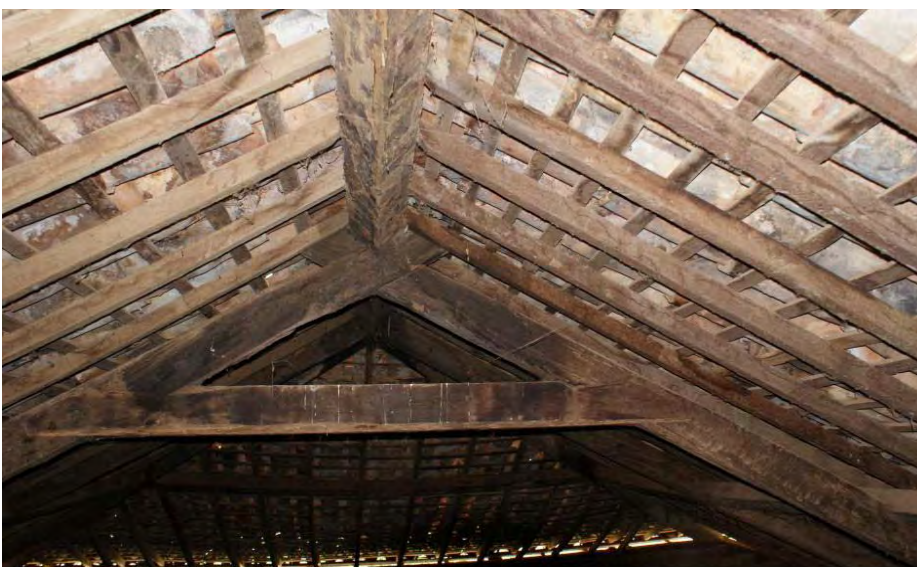
Figura 6 – Tesoura do tipo Cangalha ou Canga de porco no Telhado da Casa Sede da Fazenda Fortaleza
