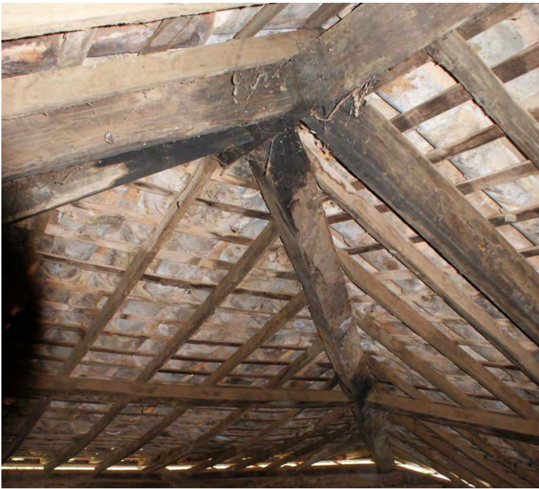
Figura 5 – Tesoura do tipo Asna sem Pendural do telhado da Casa Sede da Fazenda Fortaleza
